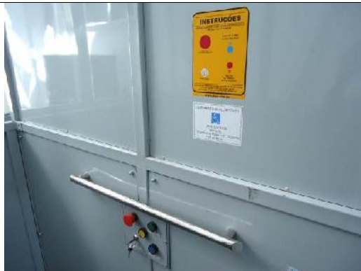
Foto 006 – Vista interna do elevador – prédio da Gerencia Executiva INSS-RR.
