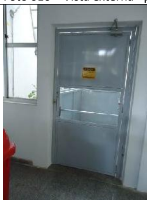
Foto 012 – Acesso de entrada do elevador - piso inferior.
